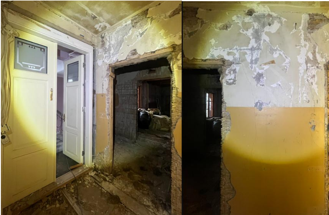
Foto 1. Seinamaalingu vaade I enne konserveerimist (vasak foto).
