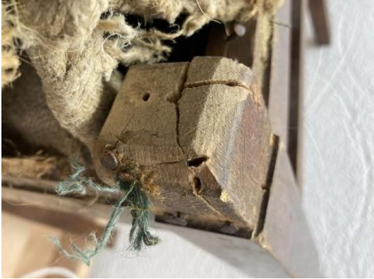
Foto 8. Lõhed esijala ülemises otsas
