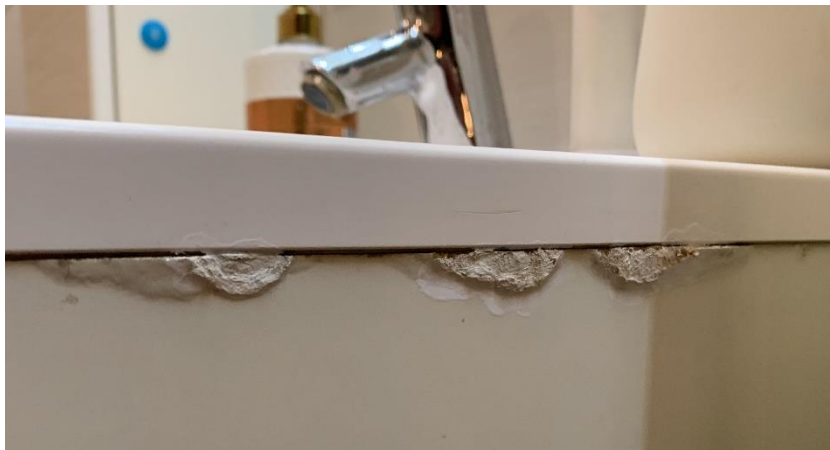
Joonis 1.13. Puitlaastplaadi niiskuskahjustus, mida on proovitud värviga katta. Autori foto.
