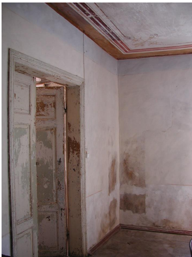
Foto 32. Salongi nurk pärast restaureerimist. Pildil avatud sondaažiava. (M. Liilap)
