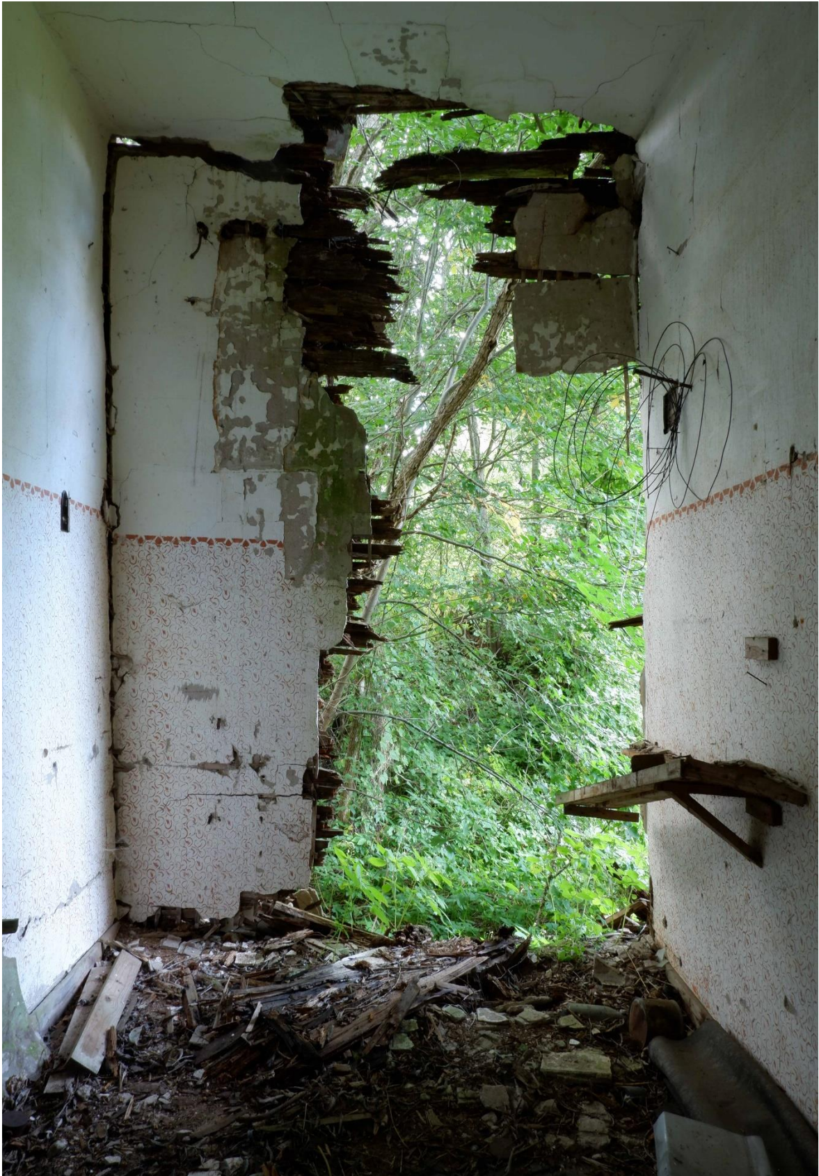
Pilt 106. Läbi mädanenud seinosa Rimmu elektrijaama tagumises ruumis
