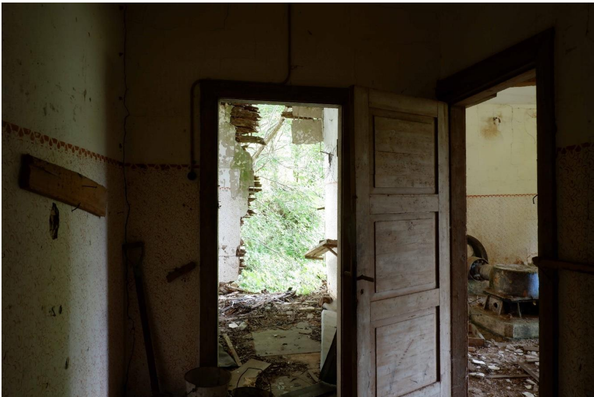
Pilt 105. Keskmine ruum Rimmu hüdroelektrijaamas
