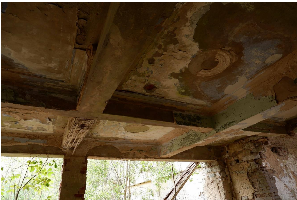
Pilt 60. Monumentaalne kassetilaegi Viivikonna Kaevanduse administratiivhoone fuajees
