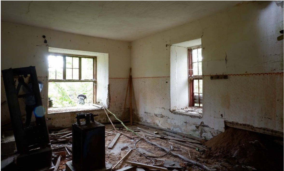
Pilt 109. Elektriijaama pearuum koos paljaks varastatud seadmetega
