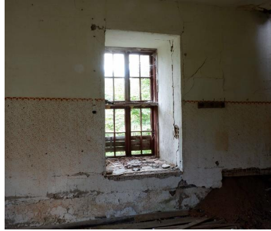
Pilt 36. Rimmu hüdroelektrijaama interjäär
