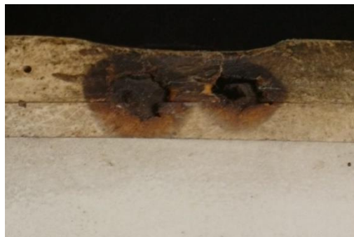
Foto 7. Roostekahjustus tagakaane käänisel.
