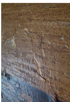
Pilt 15. Krakelee ja mehhaanilised kahjustused
