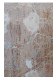
Pilt 18. Mehaanilised kahjustused
