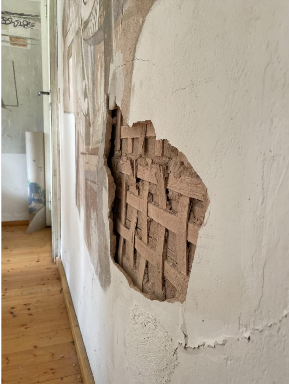
Foto 1 Krohvi seinast irdumine
