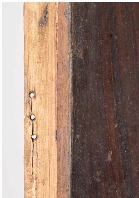
Foto 6. Lõhenenud puit korpusel.
